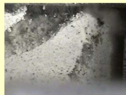
浸水前の亀裂
