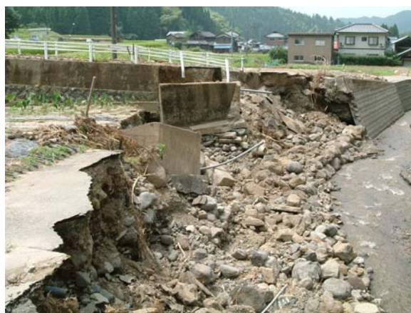
写真－9 浄教寺町での被害 2
