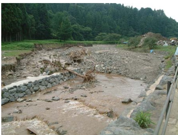
写真－7 土砂埋塞した河道
