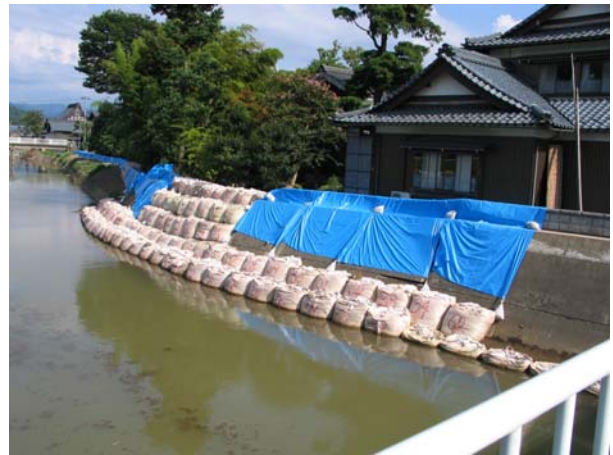
写真－16 鯖江市落井町での擁壁護岸の損壊
