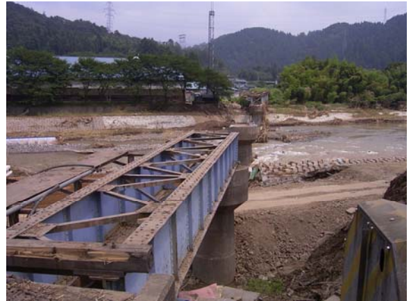
写真－2 流された鉄道橋梁
