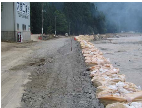
写真-13 護岸損壊による道路流失
