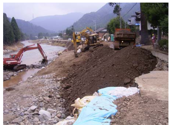
写真-14 美山町折立での護岸損壊
