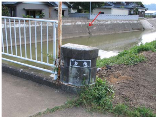
写真－17 被災しなかった擁壁護岸の状況
