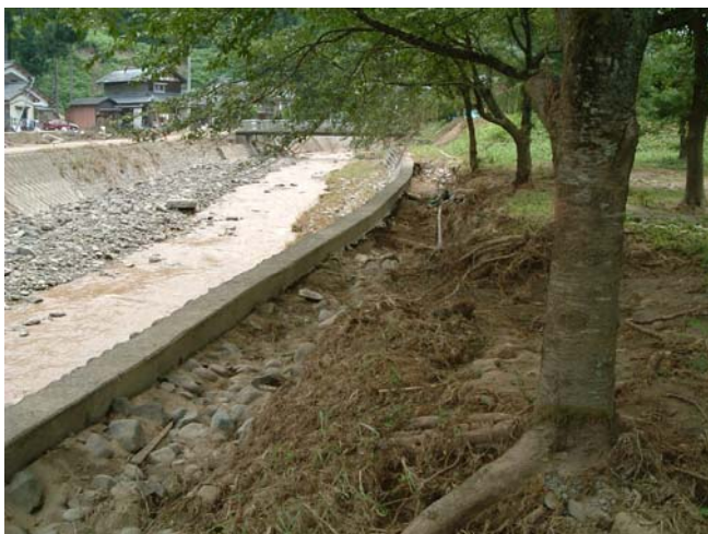
写真－6 天端から背面土砂が流出した護岸
