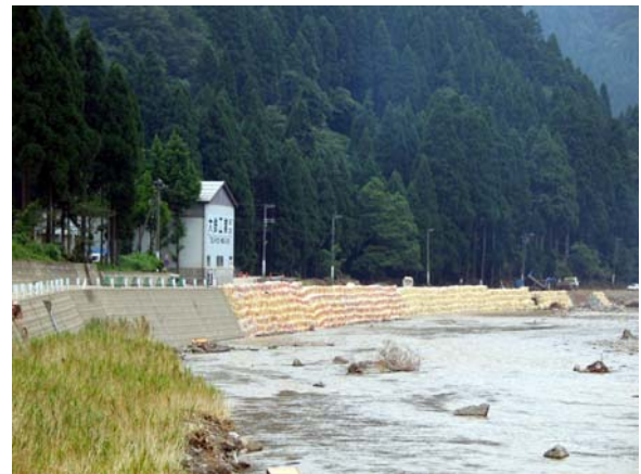
写真-12 美山町朝谷の護岸損壊
