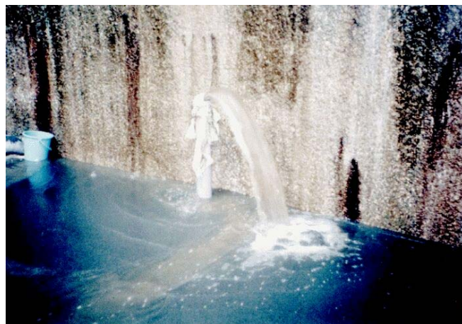
↑ 出水当初の状況 厚さ 50cm のコンクリート盤の下に通した水抜きパイプから 2,000t/日の湧水
