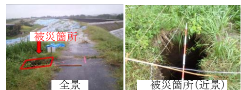
写真1 樋門周辺地盤に発生した空洞 1)
