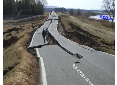
写真 1 河川堤防の変状被害 (東北地方整備局 HP より)
